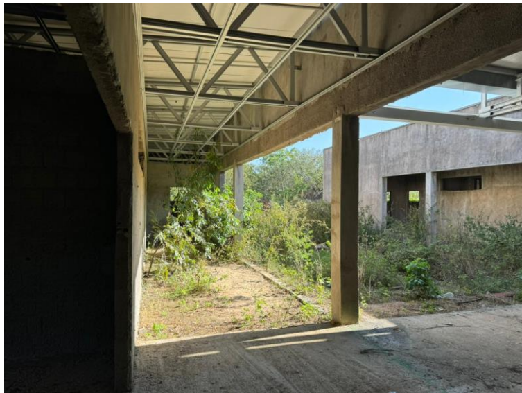
Figura 3 – Presença de vegetação e contrapiso incompleto. Fonte: elaboração própria.
