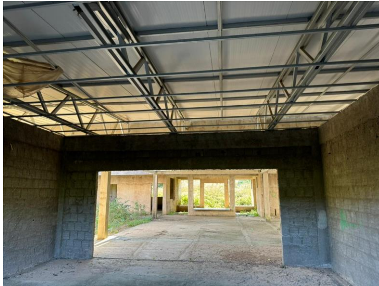
Figura 2 – Ausência de reboco. Fonte: elaboração própria.
