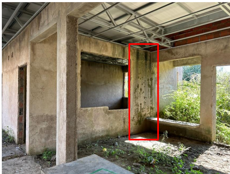
Figura 7 – Pano de alvenaria rebocado com presença de lodo. Fonte: elaboração própria
