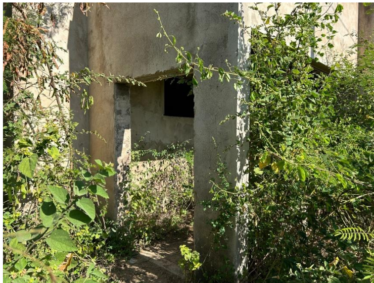
Figura 6 – Bloco A com vegetação indesejada no contrapiso não executado. Fonte: elaboração própria
