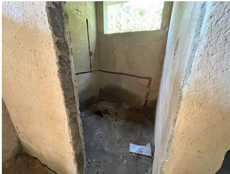
Figura 8 – Ausência de Instalações hidráulicas. Fonte: elaboração própria.
