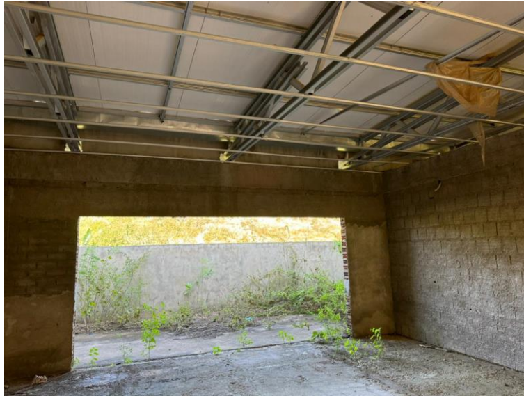
Figura 43 – Ausência de reboco e presença de vegetação. Fonte: elaboração própria.
