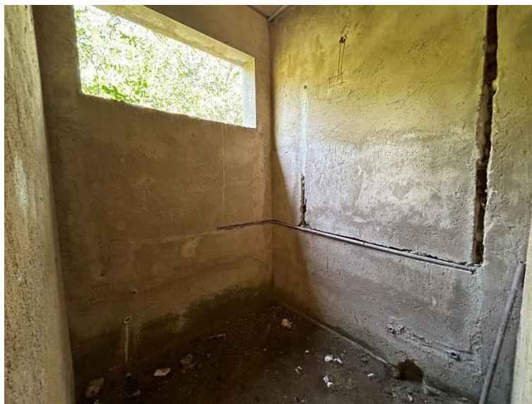
Figura 9 – Instalações hidráulicas incompletas. Fonte: elaboração própria.
