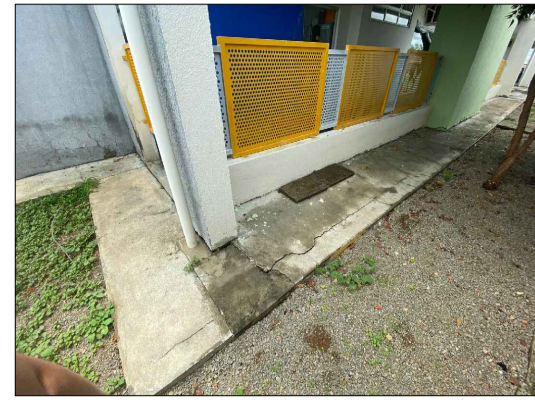
RECUPERAÇÃO DE PISO COM RECALQUE NA PARTE EXTERNA
