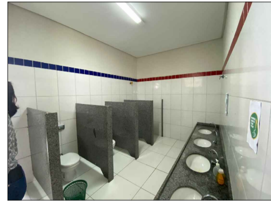
CONSERTAR DESCARGAS QUE NÃO FUNCIONAM, SE NECESSÁRIO, TROCÁ-LAS
