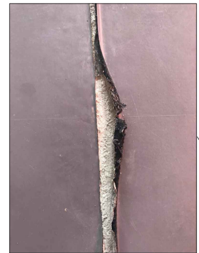
REPARO DE PISOS DE BORRACHA COM DESCOLAMENTO
