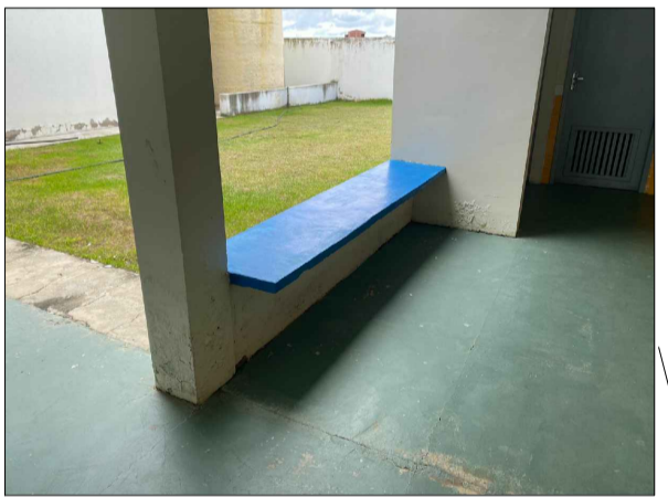
RECUPERAÇÃO DE PINTURA E GESSO COM INFILTRAÇÕES
