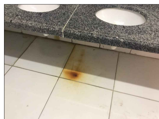
REPARO DE INFILTRAÇÃO NA TORNEIRA, E TROCA DE PISO DE PISO CERÂMICO DANIFICADO
