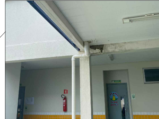
REPARAR DESPLACAMENTO DE COBERTURA DA VIGA
